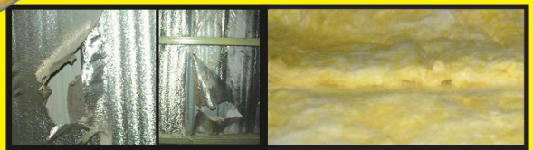
PE Foam deteriorates after 1 year
