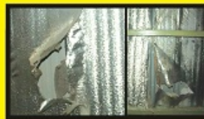
PE Foam deteriorates after 1 year
